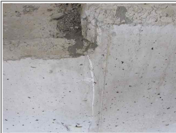
대성교(상주) P1 코핑부 균열 (0.3mm미만)
