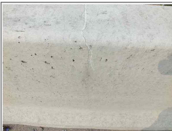
대성교(영천) S2 방호벽 균열 (0.3mm이상)
