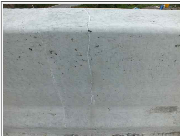
대성교(상주) S4 방호벽 균열 (0.3mm이상)
