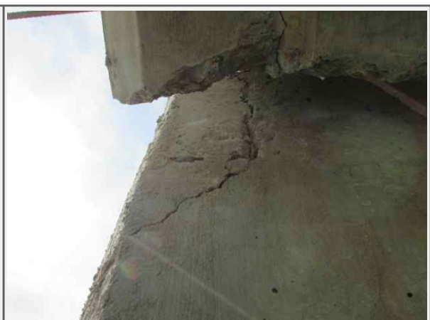
대성교(영천) A1 홍벽 파손
