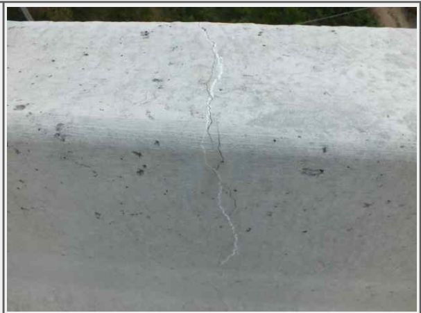
대성교(상주) S2 방호벽 균열 (0.3mm이상)
