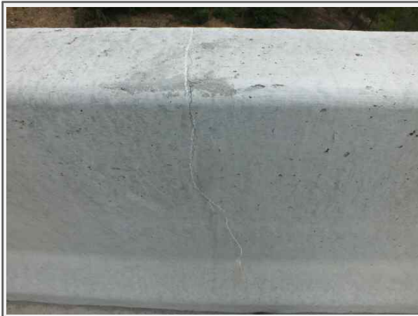
대성교(상주) S1 방호벽 균열 (0.3mm미만)
