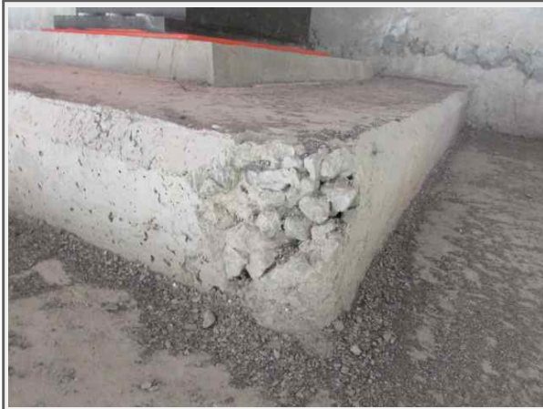
대성교(상주) A1 받침콘크리트 재료분리
