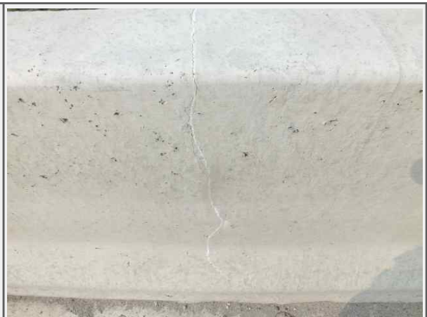
대성교(영천) S1 방호벽 균열 (0.3mm이상)
