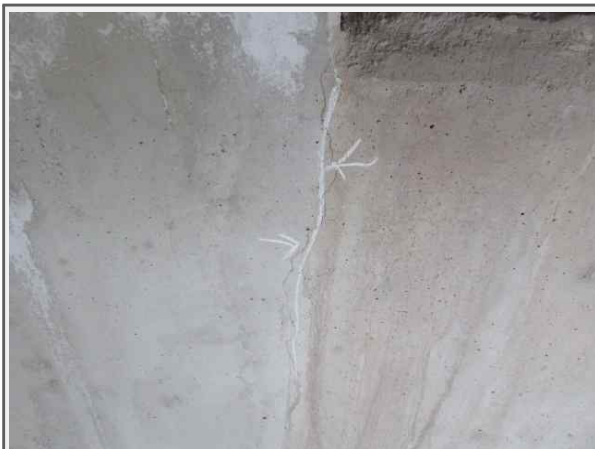
대성교(상주) A1 벽체 균열 (0.3mm미만)
