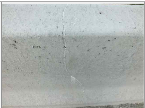
대성교(영천) S4 방호벽 균열 (0.3mm이상)
