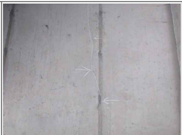
대성교(상주) A1 홍벽 균열 (0.3mm미만)
