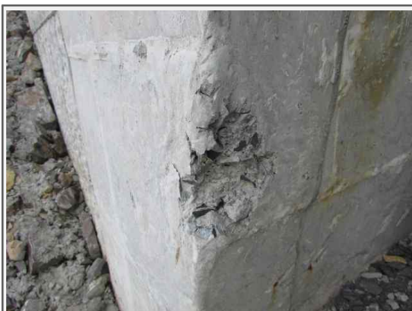
대성교(상주) A2 벽체 파손
