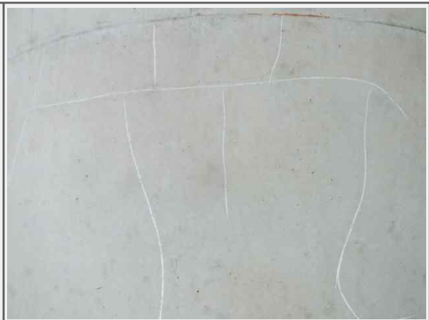
대성교(상주) P2 기둥부 망상균열
