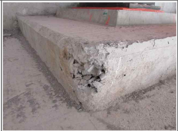
대성교(영천) A1 받침콘크리트 재료분리
